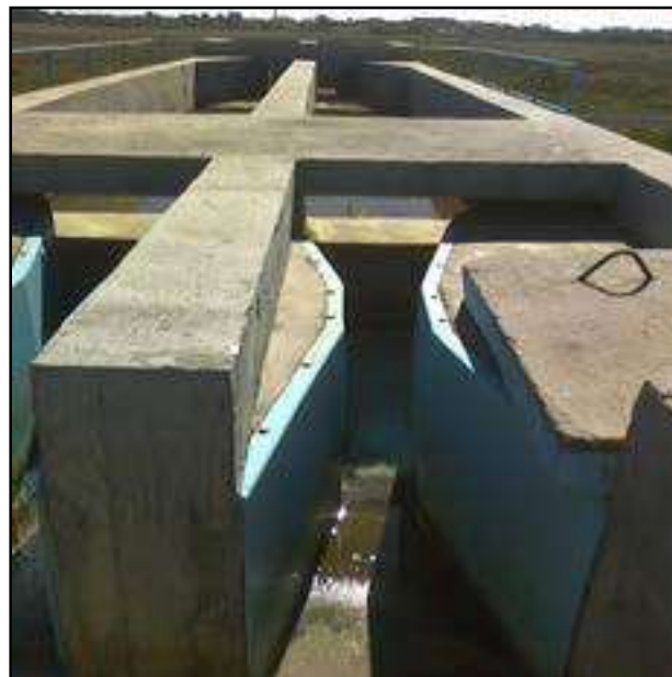
Figura 27 - Calhas Parshall (Fonte STE)
