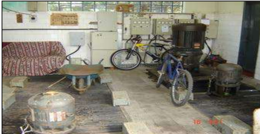
Figura 12 – Motores e quadros de comando da casa de bombas (Fonte STE)
