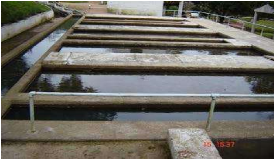
Ilustração 20 - Conjunto de pequenos tanques de filtragem
