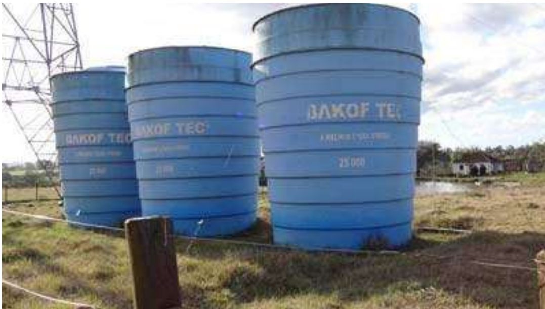
Ilustração 024 – Vista dos reservatórios, localizados na Colônia Corrientes.
