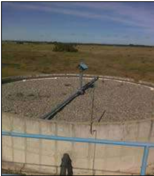
Figura 32 - Vista superior do filtro biológico (Fonte STE)
