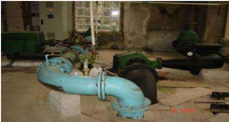
Ilustração 13 - Motores, bombas, tubulação e poço de sucção
