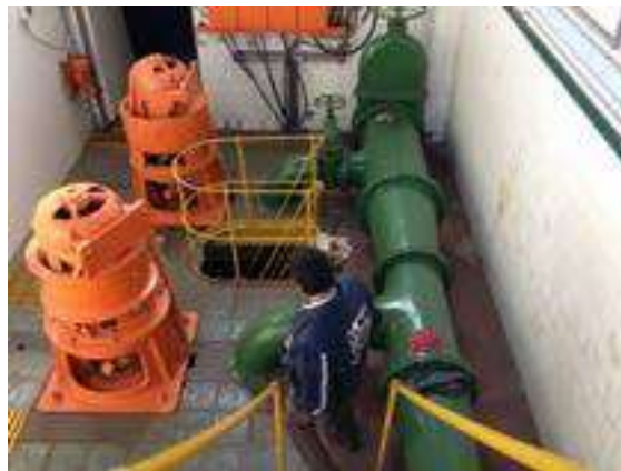
Sistema de bombas ELE – US-I (Fonte STE)
