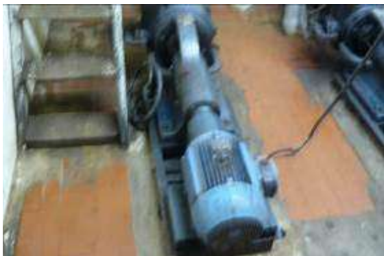
Motores Elevatória Saldanha Marinho US-II . (Fonte STE)
