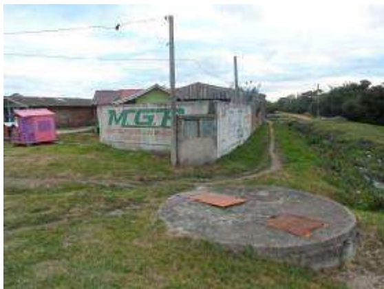
Quadro de comando ELE – Ceval. (Fonte SANEP)
