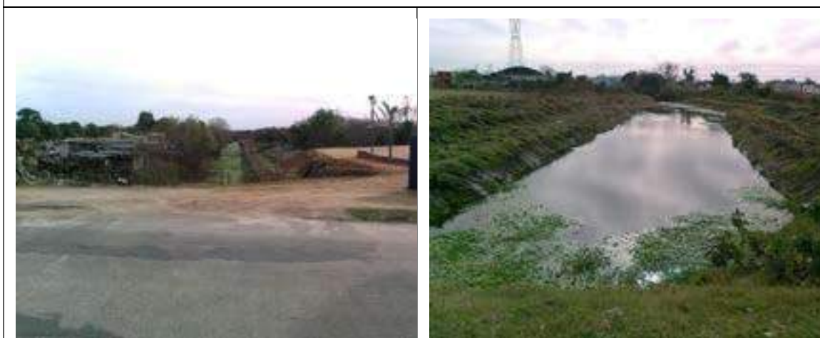
Figura 27: Vila Castilho, ponto crítico de alagamento.
