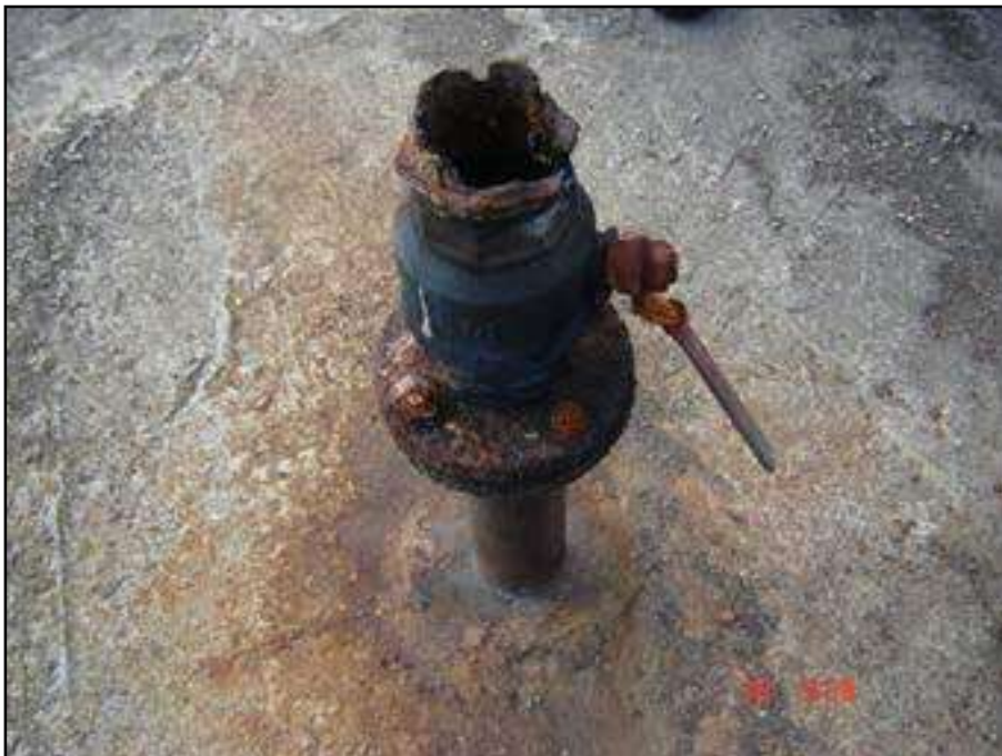
Figura 21 - Queimador de gás desativado (Fonte STE)
