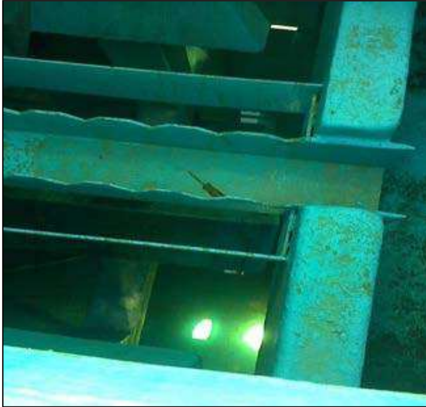
Figura 30 - Calhas internas dos reatores (Fonte STE)
