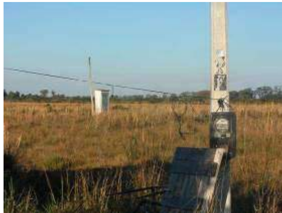
Quadro de comando ELE – Ceval. (Fonte SANEP)
