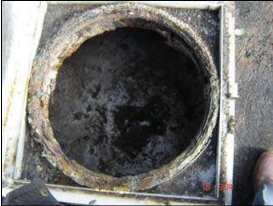
Figura 20 - Caixa de inspeção na parte superior do reator (Fonte STE)
