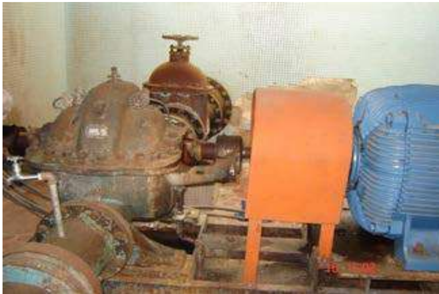
Ilustração 32- Conjunto motobomba 4ª EEAT
