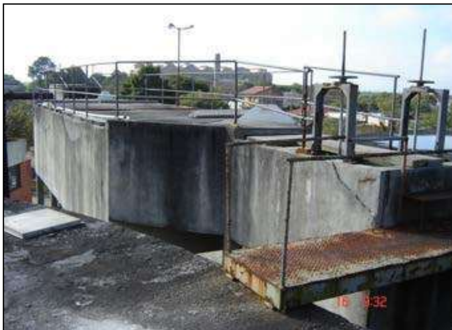
Figura 17 - Desarenador e calha Parshall (Fonte STE)
