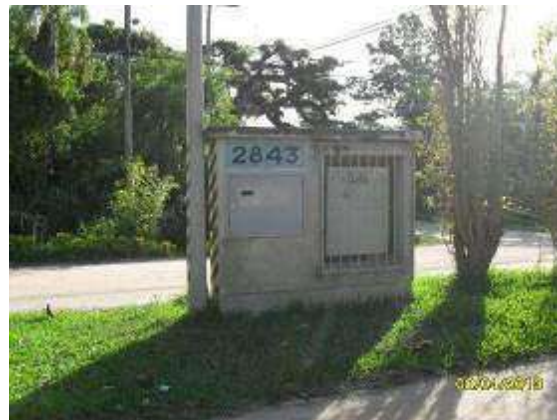
Quadro de comando ELE - L2. (Fonte SANEP)
