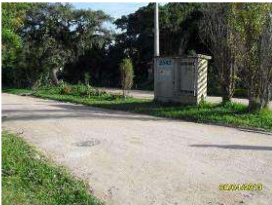
Local da Elevatória L2. (Fonte SANEP)
