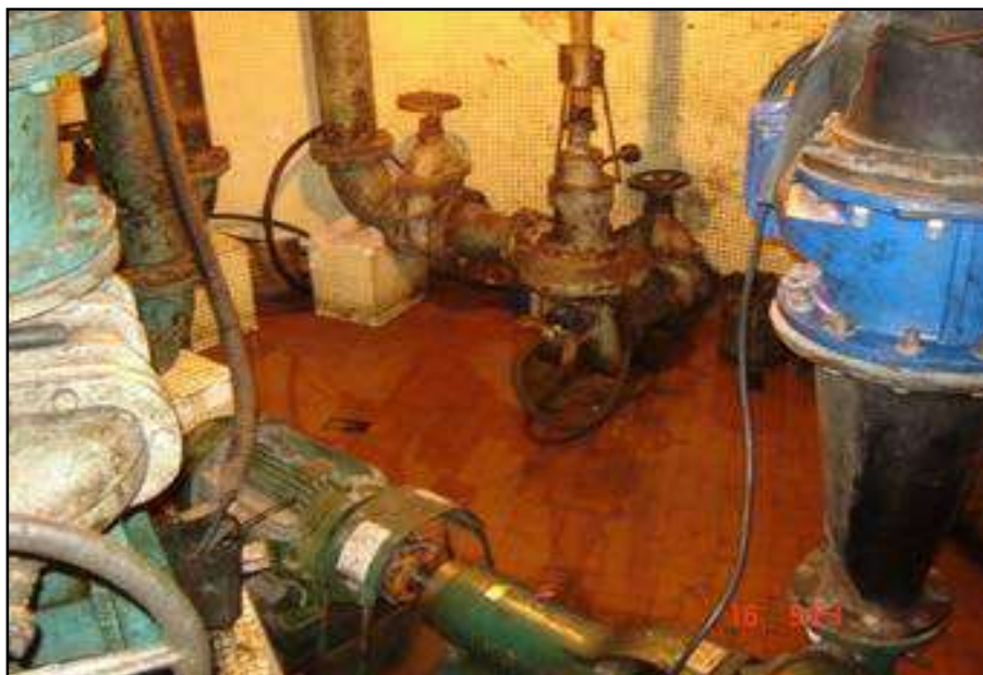
Figura 14 - Vista dos conjuntos moto-bomba no subsolo (Fonte STE)
