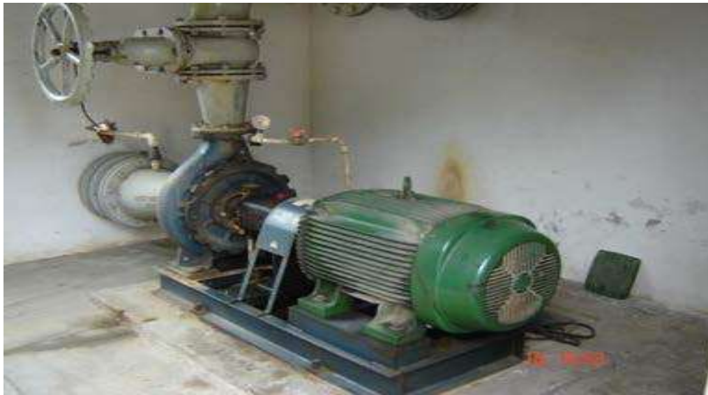
Ilustração 29 - Conjunto motobomba 1ª EEAT
