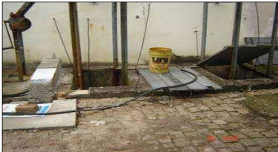
Figura 11 - Chegada do efluente na ETE (Fonte STE)
