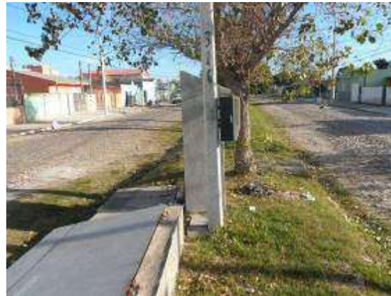
Quadro de comando ELE – Fátima. (Fonte SANEP)
