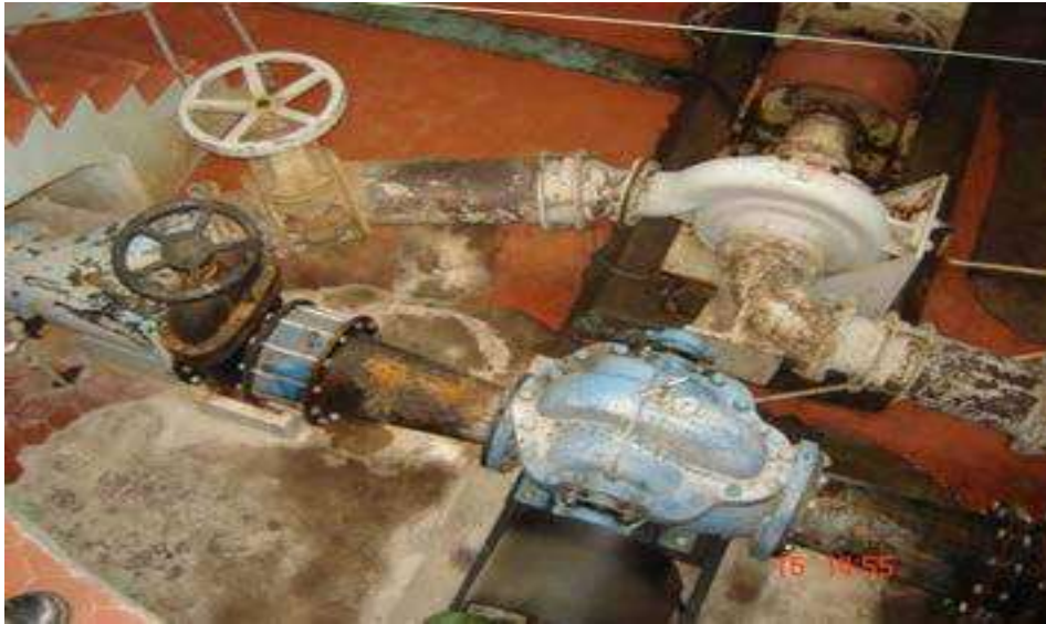
Ilustração 31 - Conjunto motobomba 3ª EEAT
