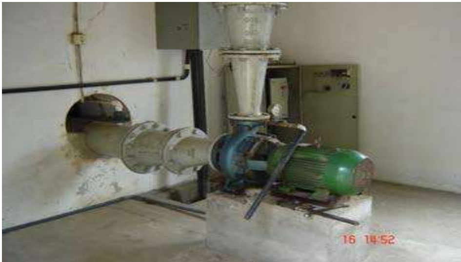
Ilustração 30 - Conjunto motobomba 2ª EEAT
