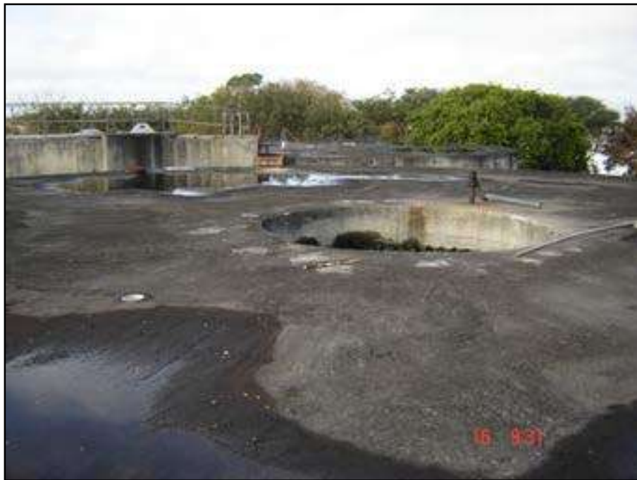
Figura 19 - Vista superior dos reatores (Fonte STE)
