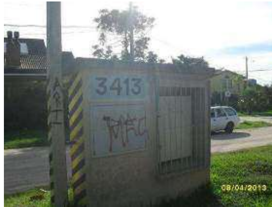
Quadro de comando ELE - L1. (Fonte SANEP)
