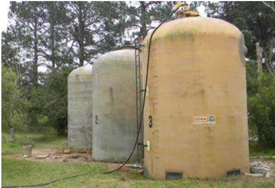
Ilustração 42 – Tanques de PAC
