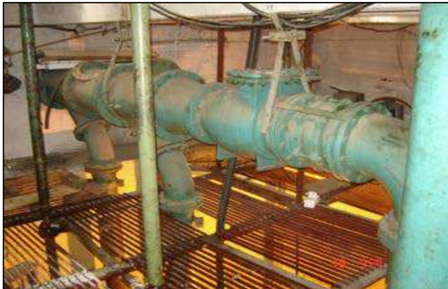
Figura 13 - Barrilete de recalque (Fonte STE)
