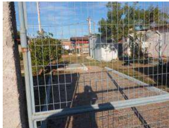
Quadro de comando ELE – Navegantes. (Fonte SANEP)
