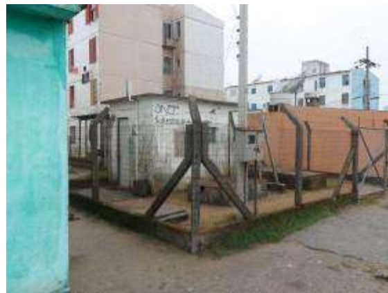
Quadro de comando ELE – Cohab Pestano. (Fonte SANEP)
