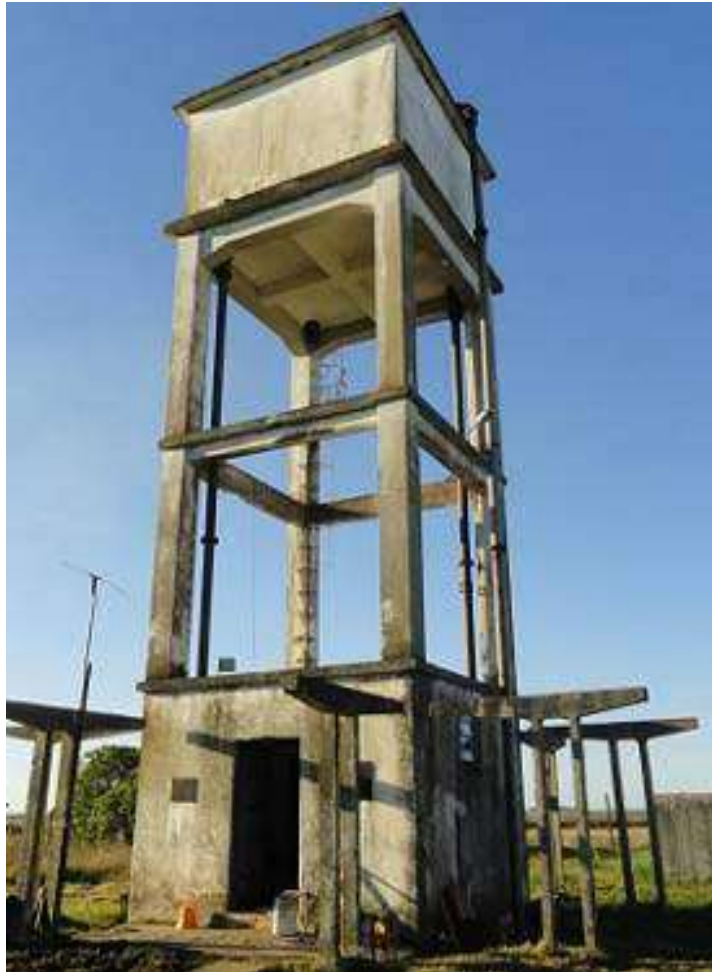
Ilustração 012 – Vista frontal do Reservatório localizado na Colônia Z3.
