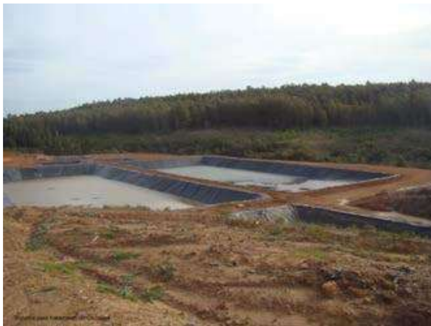
Figura 3.43 – Lagoas de estabilização para tratamento dos lixiviados
