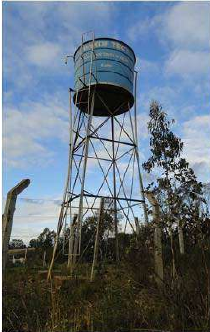
Ilustração 022 – Logo em seguida, uma caixa d'água de 5.000 litros é abastecida, indiretamente, pelo MB-3, servindo, também, como amortecimento de energia da água. Possui tubulações de entrada e saída com mesmo diâmetro, ambas DN 50.
