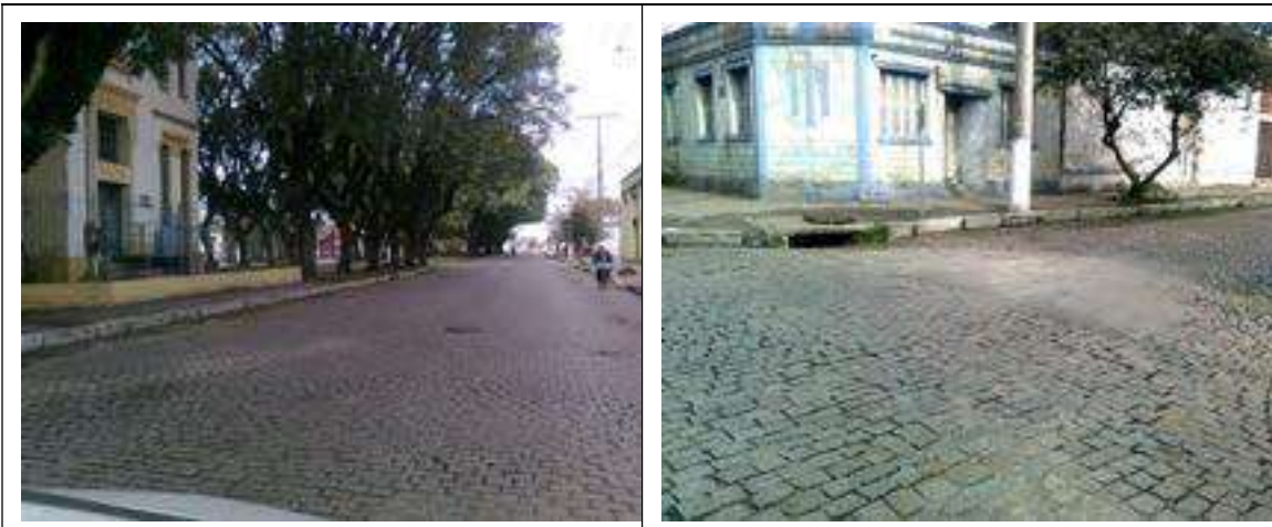
Figura 11: Dispositivos de microdrenagem superficial
