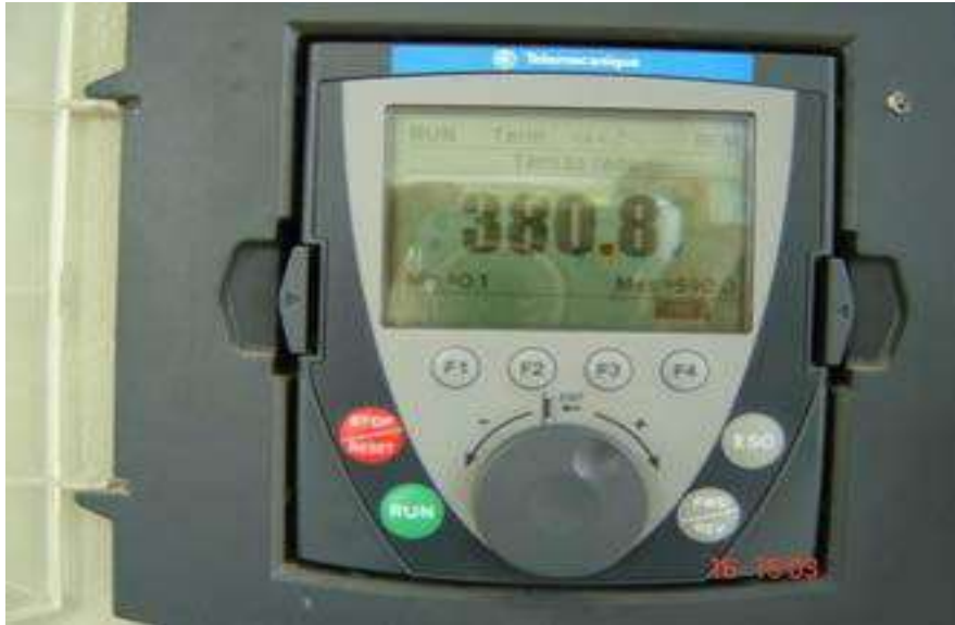
Ilustração 33 - macro medição adutora 4ª EEAT
