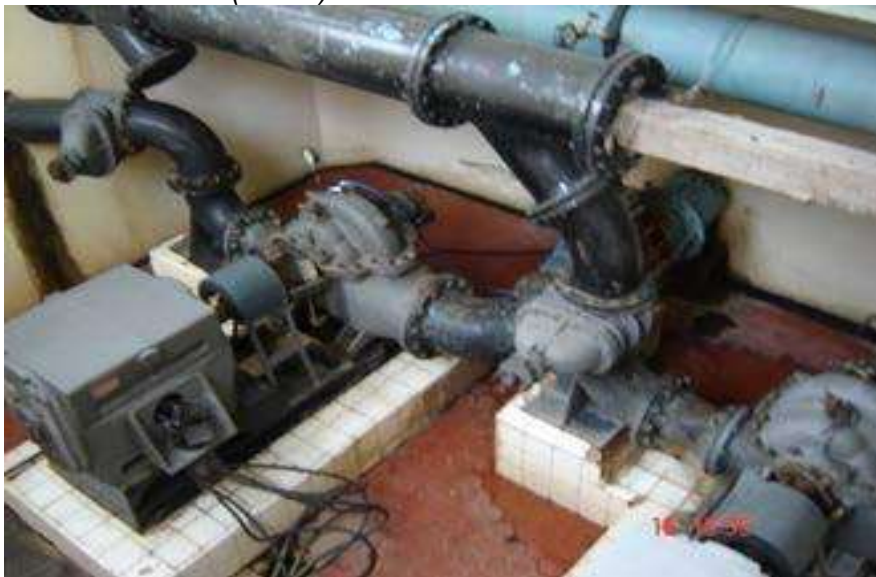
Ilustração 18 - Vista dos conjuntos motobomba 300 mm
