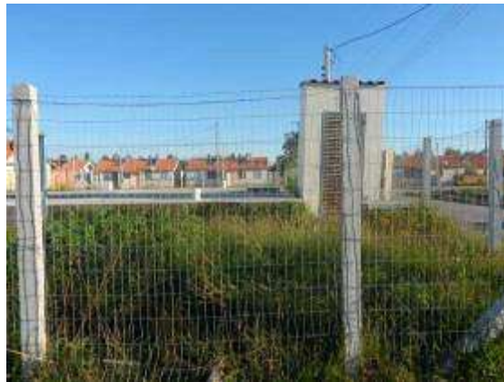
Quadro de comando ELE – Eldorado. (Fonte SANEP)
